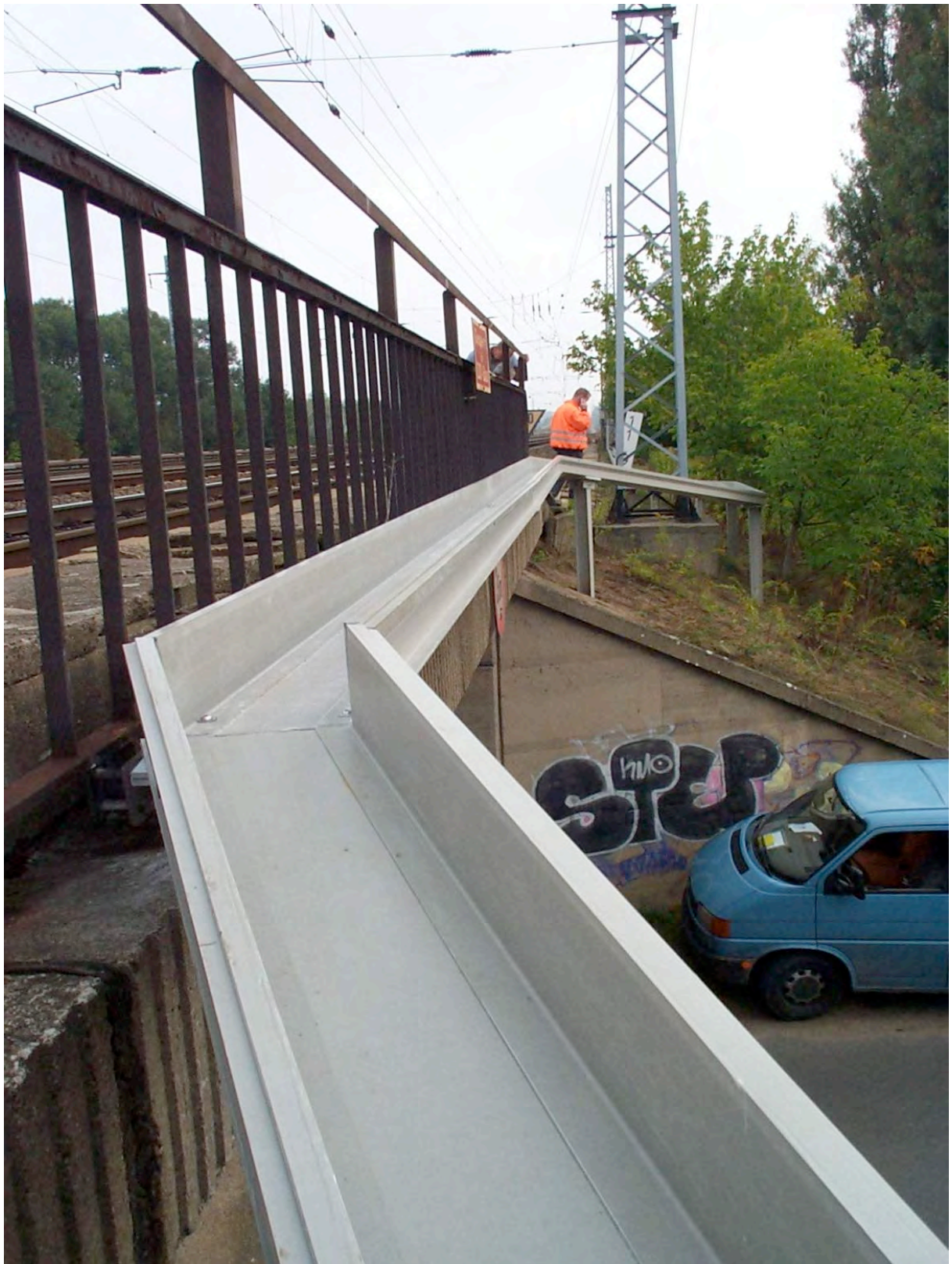
CABSYS RAIL am Brücken-Geländer
