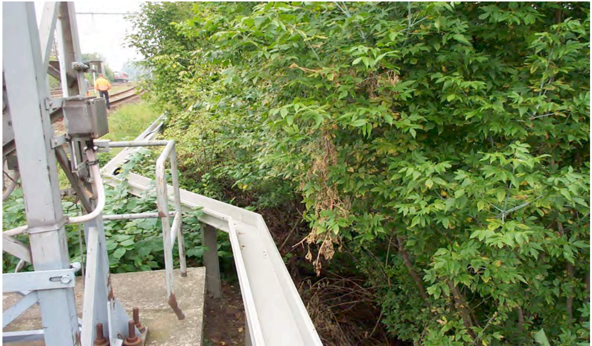
CABSYS RAIL im schwierigen Hangbereich mit Mastumgehung
