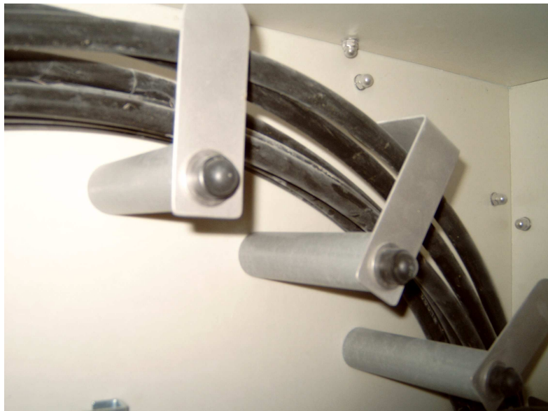
Bild 3: Kabelablage mit Kabelhalterung
